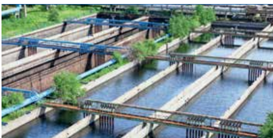
Tank til industrielt prosessvann
